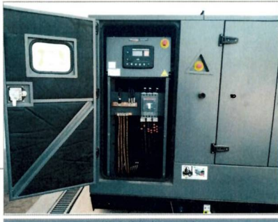
Conexión de planta de emergencia.
